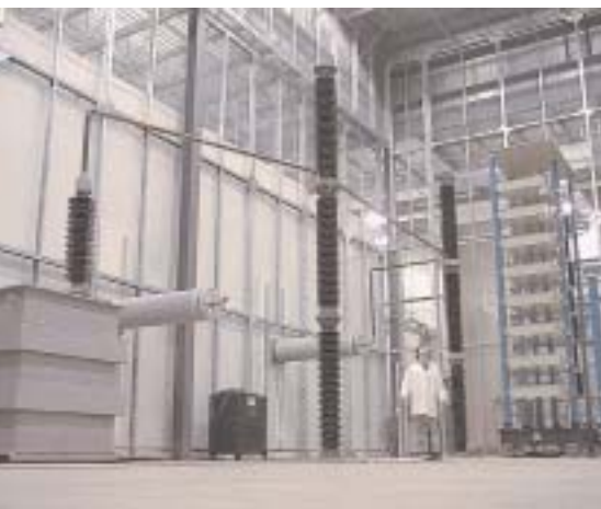
Laboratoire haute tension
